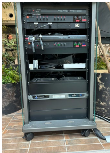
▲音響機器を制御するラック。スピーカーを駆動するパワーアンプのほか、音量コントロール、プログラムタイマーなどをマウントしている。
